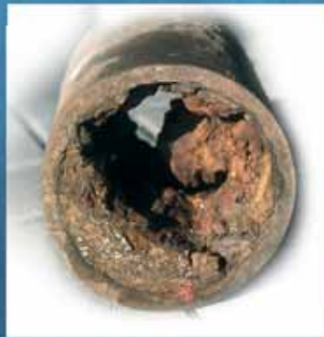
Rohrschnitt einer typischen Nordhäuser Gussrohrleitung mit Inkrustierung
