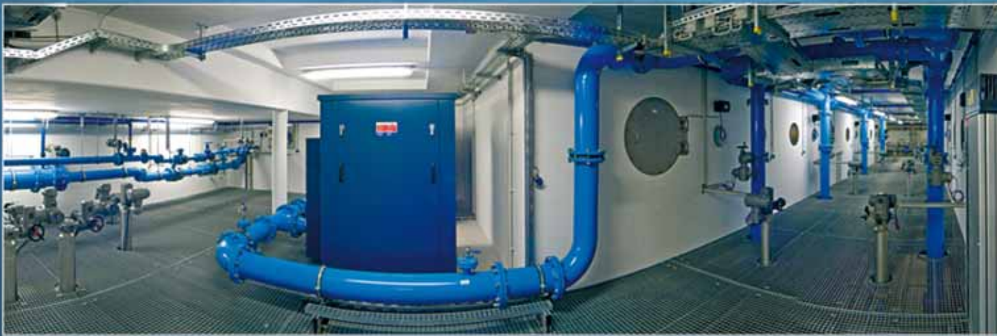
CaCo 3 Filterkeller im neuen Wasserwerk Nordhausen
